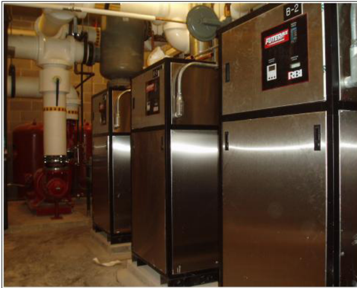
(4) RBI Futera III Boilers 1500 MBH
